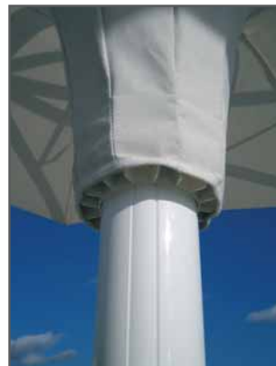
Desagüe de aguas en la zona del mástil
